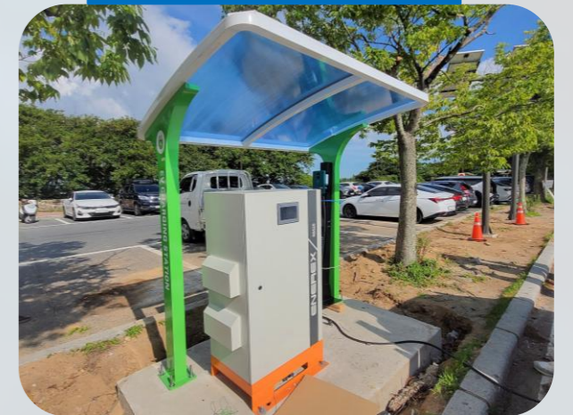
태양광 연계 전기차 충전 (경주)
