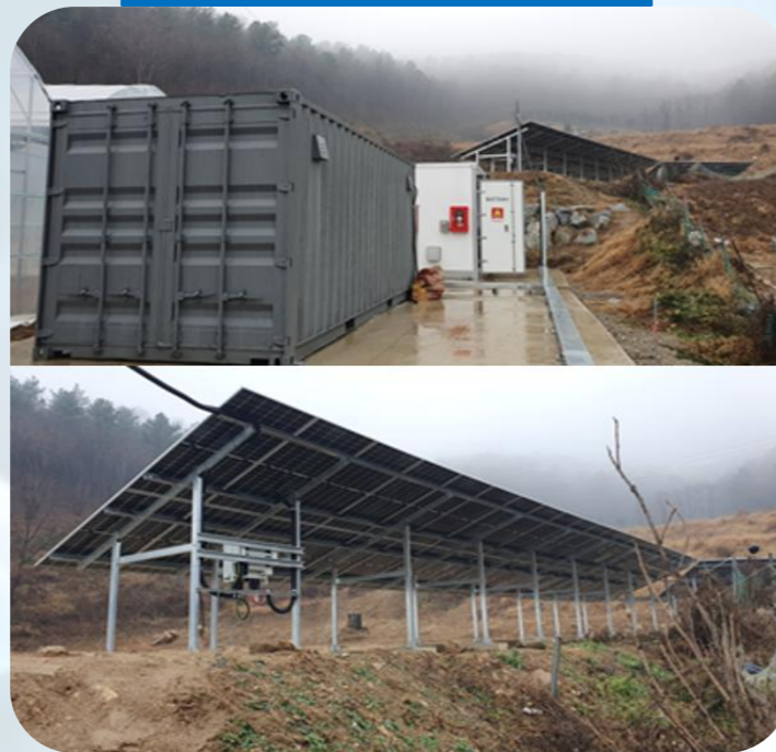
스마트팜 태양광 연계 ESS (양평)
