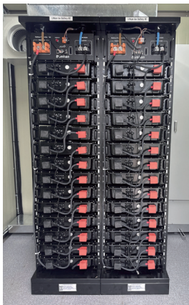
▶ 청주 예술의 전당, 111kWh 2Racks
